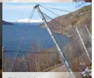
Sistemi antivalanga e barriere paramassi
